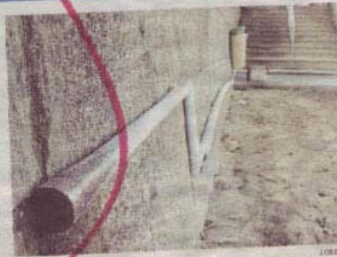
Las cañerías de agua caliente no conducen ahora a ninguna parte
